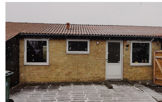
Bemærk den lave konstruktion og isoleringsmængde i overgangen mellem facade og tagfod.
