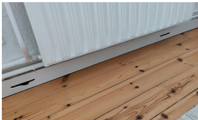
Synlige luftspalter i de gamle fodlister.
